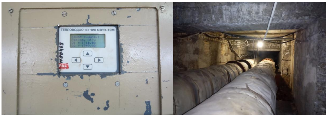
Прилад обліку теплової енергії та його підключення до трубопроводів
