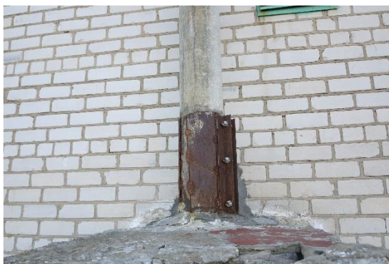
Рисунок 1.9 – Пошкодження димової труби
