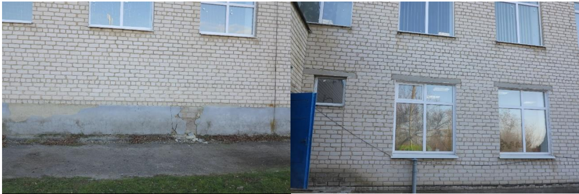
Рисунок 1.3 – Локальні пошкодження стін будівлі
