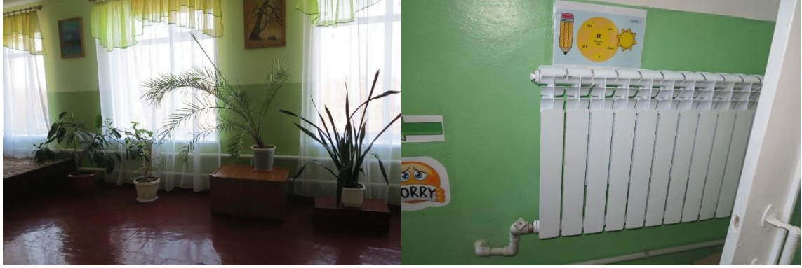
Рисунок 1.10 – Опалювальні прилади: реєстри та біметалевий радіатор в коридорі
