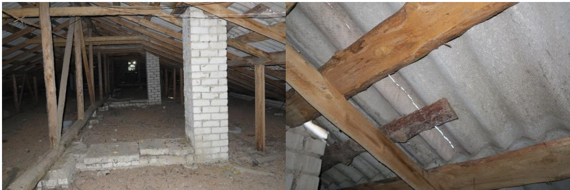
Рисунок 1.6 – Горищне перекриття та азбесто-цементне покриття
